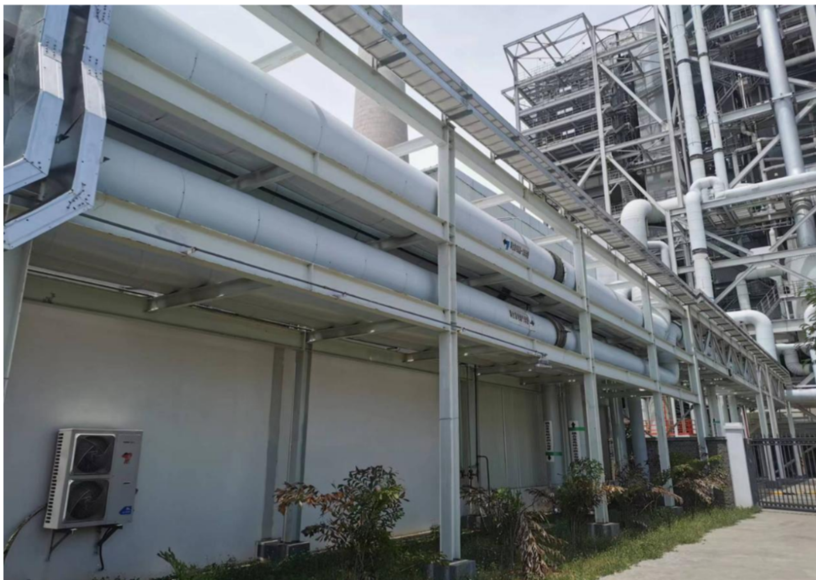
飞灰沸石基材料生产线烟气热源管道设施（升级改造前）
